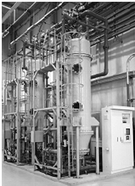
図 6 高速ろ過装置
