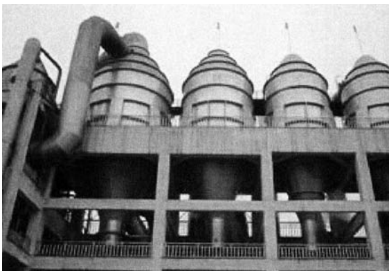
写真7 プラントの外観
