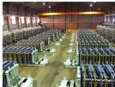
イオン交換膜電気透析槽
