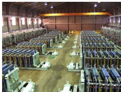
イオン交換膜電気透析槽
