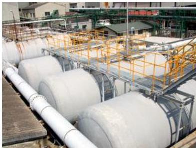
2次砂ろ過装置
