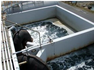
1 次砂ろ過装置
