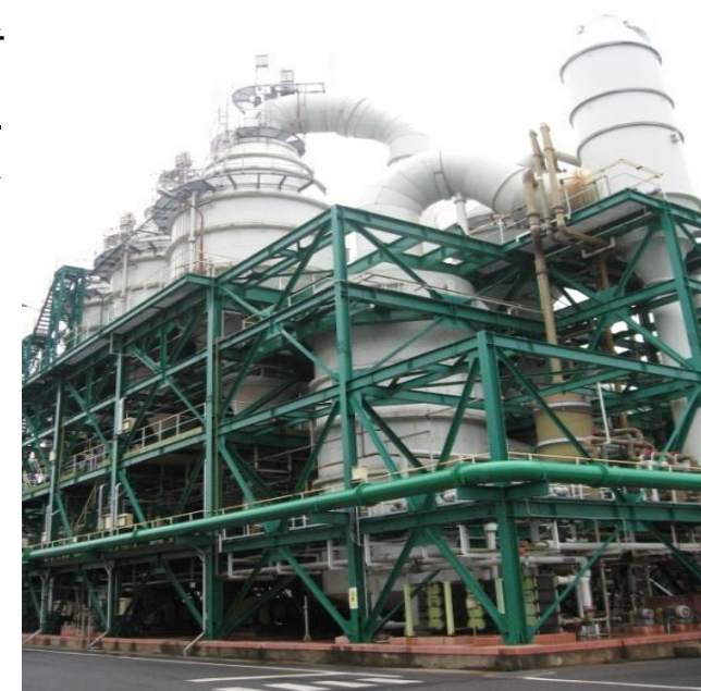
真空多重効用式蒸発缶(たて釜)
