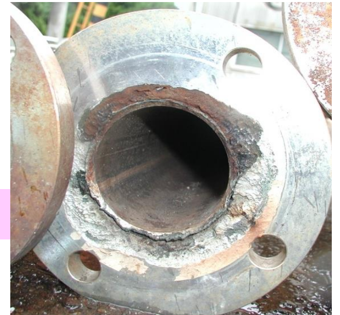
フランジ面に生じた「すきま腐食」
