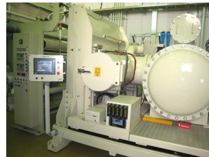
パイロットスケール電子線照射装置
